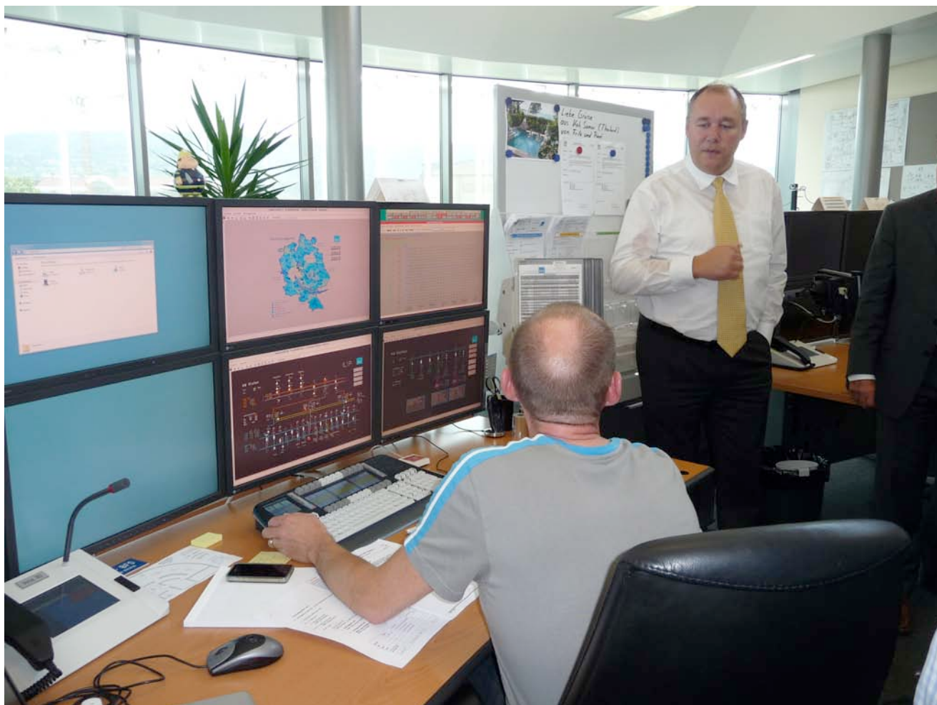
CEO Dr. Urs Rengel präsentiert die neue Zentrale Leitstelle EKZ, mit der die Netze im ganzen Kanton Zürich überwacht und gesteuert werden.
